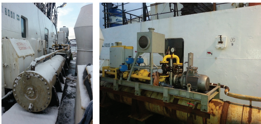
Рис. 2. Компактный моноблок трубы-цилиндра (с поршнем-грузом) и насосная станция на ней, размещенные на верхней палубе среднего рыбопромыслового судна: натурные испытания в зимнее (слева) и летнее (справа) время в Баренцевом море
