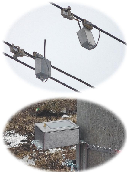
Рис. 3. Диагностические приборы, установленные на линии Санкт-Петербург – Москва: вверху – устройства контроля тросов и проводов, внизу – устройство контроля углов наклона опор
